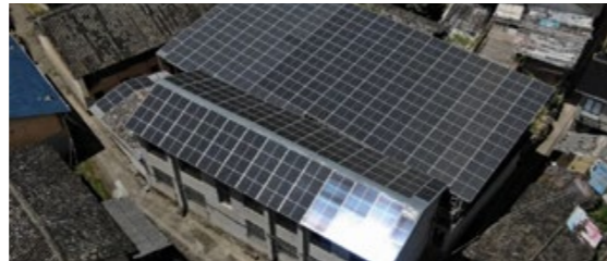
屋顶光伏项目
