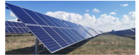
援建光伏村级电站
